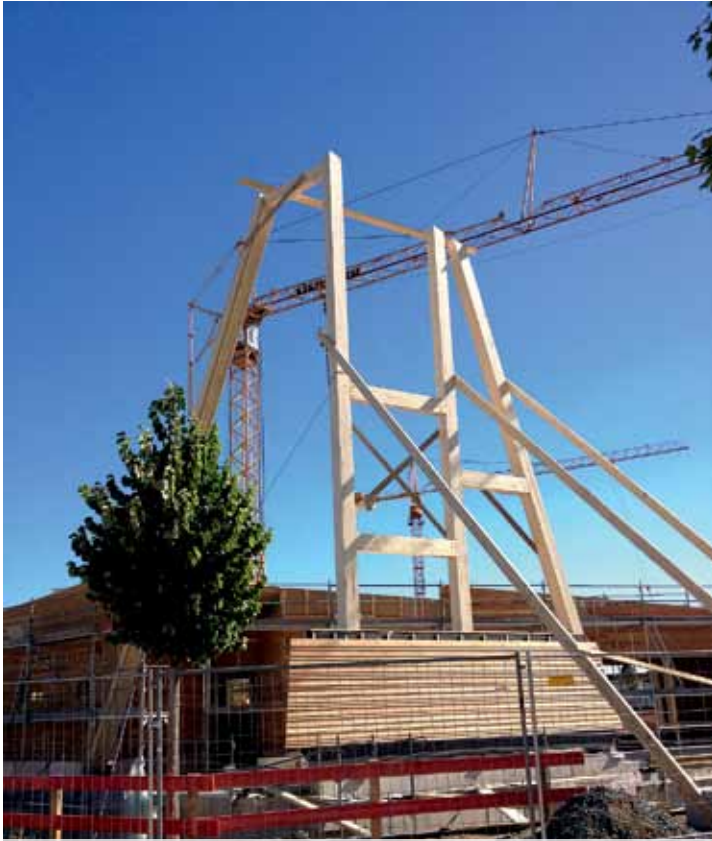
Errichtet wurde der 14 m hohe Turm mithilfe von Hubsteigern. Ein Bagerüst war für die Richtphase nicht erforderlich.
