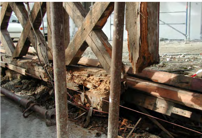
? Sanierungsbedürftiges Fachwerk der Sommerwirtschaft
