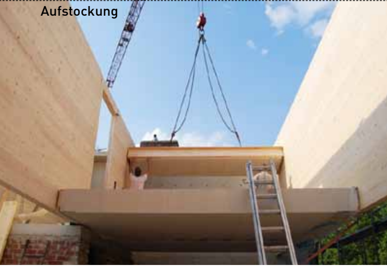
Die Aufstockung erfolgte durch Wandscheiben aus Brettsper Holz und Holztafelbau für die Decken
