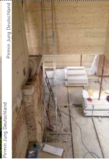
Durch die hohe Vorfertigung waren die Montagearbeiten des Holzbaus binnen einer Woche abgeschlossen
